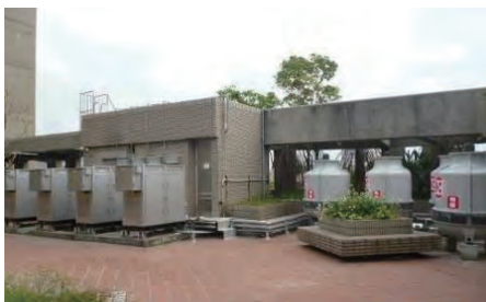
▲ 工學館空調主機
